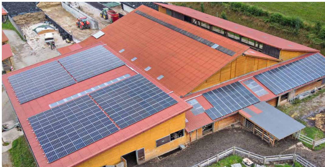
Auf den Dächern wurde eine 100 kWp PV-Anlage mit 259 Solarmodulen auf 480 qm installiert.
